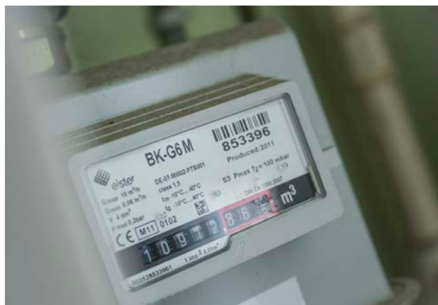
Ein Gasanschluss ist nach dem Einbau einer Wärmepumpe nicht mehr nötig.
